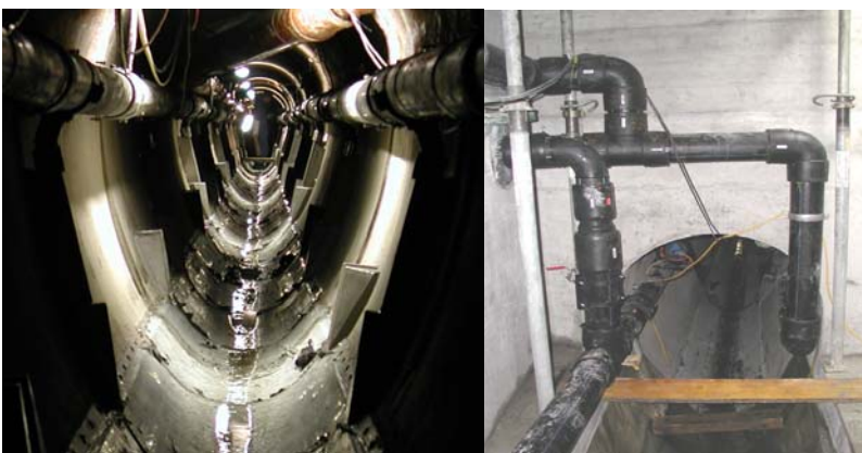
Abb. 4: Wärmetauscher im Kanal sowie Vor- und Rücklaufleitungen im Kontrollschacht in Binningen
